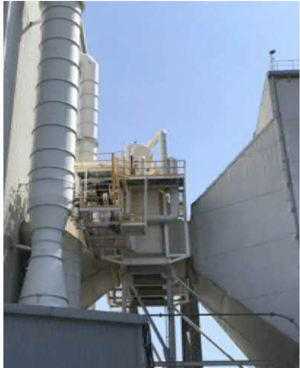
▲ 煙氣餘熱回收現場照片
