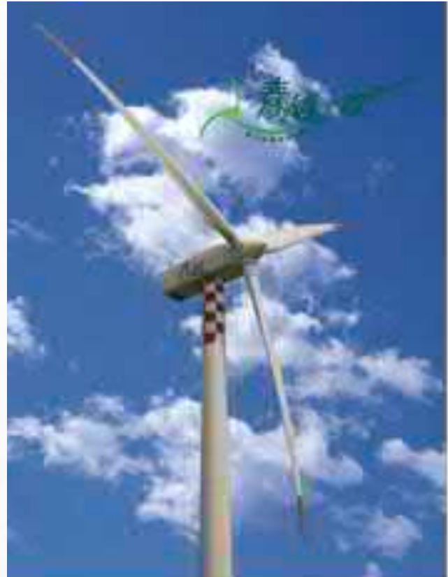
正隆竹北廠的風力發電機
