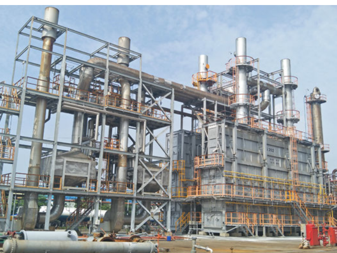
裂解爐廢熱回收設備
