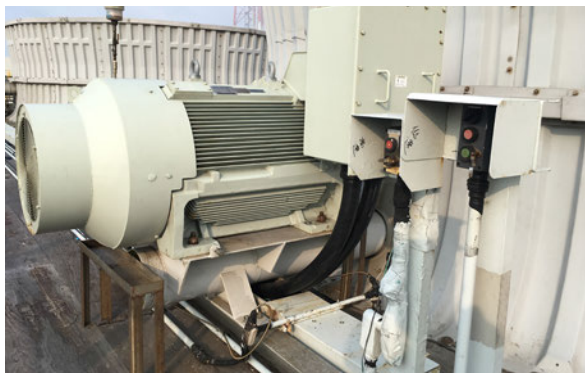
由左至右：冷卻水塔風扇改用高效率 FRP 葉片、變極馬達 (4P/8P)
