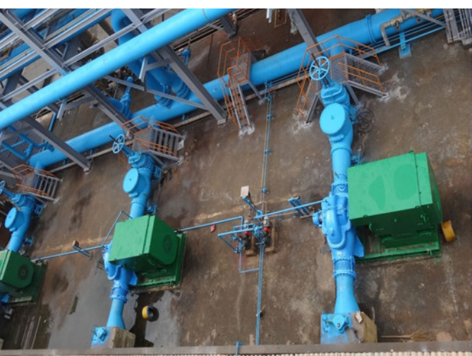
台氯林園廠 3 台冷卻水循環泵浦
