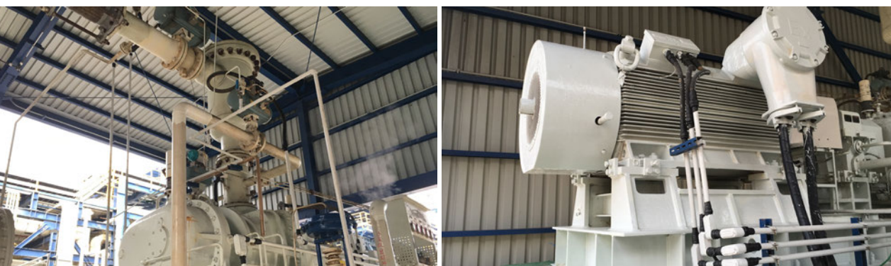
(左) 配合夏季節電，增設低壓蒸汽發電機組 (右) 設低壓蒸汽發電機組，為廠內未來降低煙囪排氣溫度預做準備
