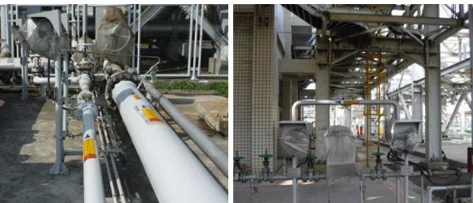
由左至右：6" 燃料氣管線、3" 燃料氣管線
