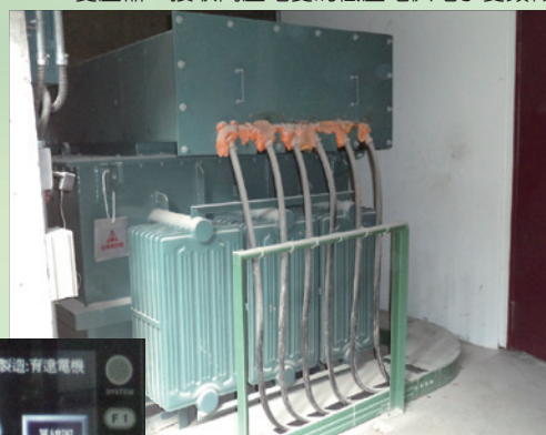
變壓器，接收高壓電變為低壓電供電子變頻機
