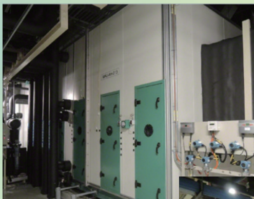
MAU出口溫度調降：MAU出口溫度調降，可大幅減少潔淨室DCC (dry cooling coil) 負載
