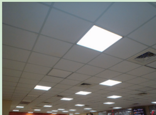
操作管理室照明由T5改成LED平板燈
