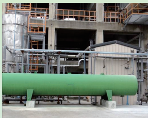
新設白液氧化設備
