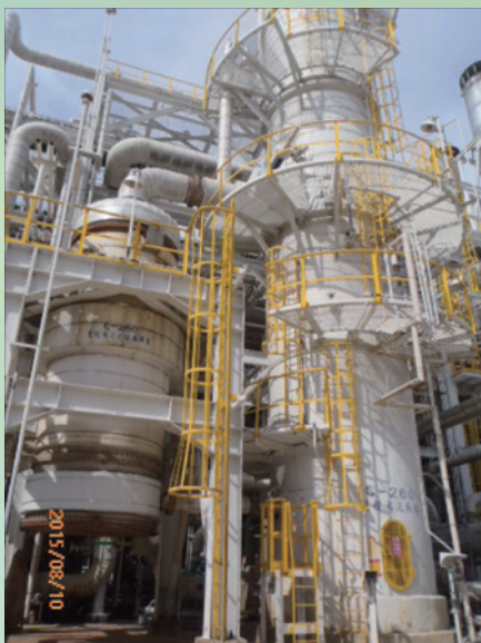
1、C-260進料水溫度由92°C提升至101°C 2、C-260進料水溫度由101°C提升至110°C
