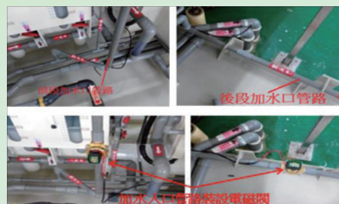
加水入口管端裝設電磁閥
