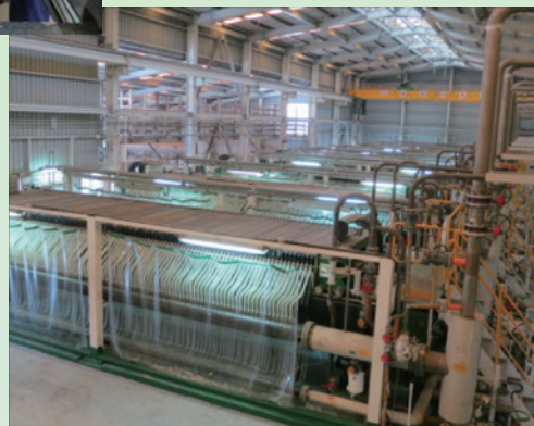
改造完成的電解槽組裝後上線運轉-2
