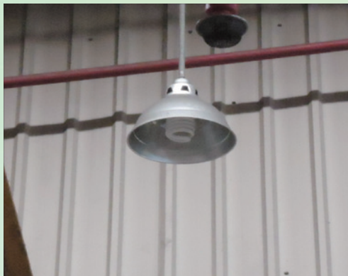
PP鍋爐區照明將原本水銀燈更換為螺旋省電燈泡
