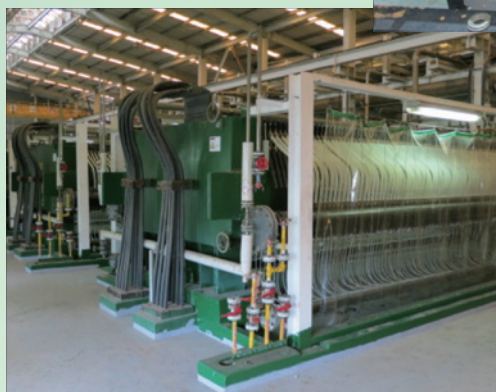
改造完成的電解槽組裝後上線運轉-1
