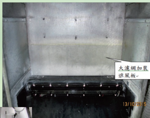
紡絲冷卻風大濾網加裝遮風板節能改善
