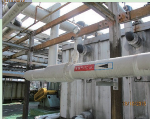
蒸汽冷凝水回收至鍋爐給水節能改善
