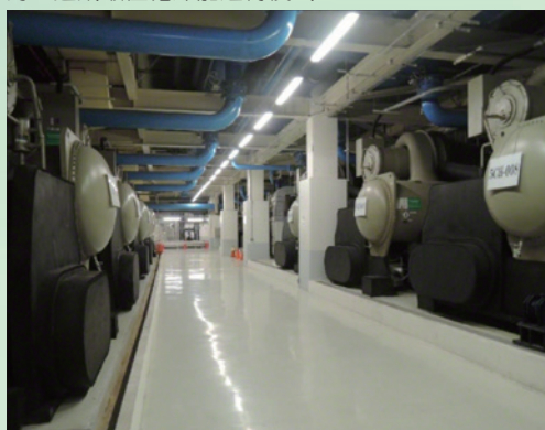
Chiller節能最佳運轉台數：由歷史運轉資料數據化冰水流量，尋找冰機維持N+1運轉時，達成最佳化節能運轉模式
