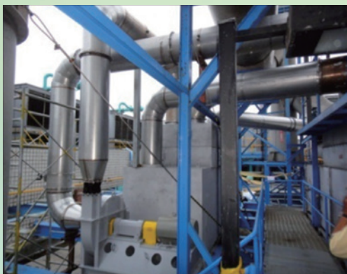
加裝第三熱交換器回收煙囪出口的廢熱
