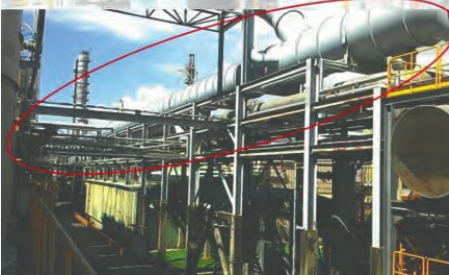
主廢氣收集管
