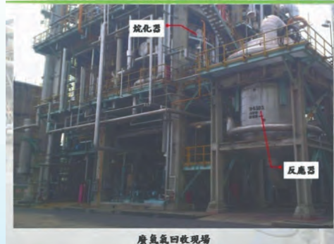
增設廢氫氣壓縮機K5102回收製程排放之廢氫氣(3)
