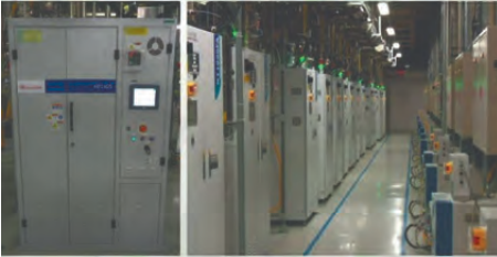
使用PFC gas機台設置有效尾氣處理設施 (Local Scrubber)
