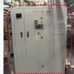
新式去除PFC local scrubber安裝
