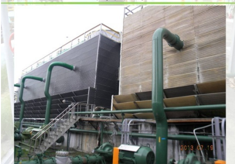
冷卻水塔改善
