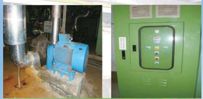
冷凍系統各水泵效率提升
