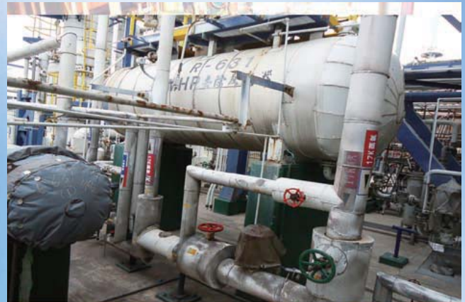
停掉MHP去除反應器(R631)加熱17K蒸汽，含MHP廢水改送至濕式氧化單元(K711)處理，減少17K蒸氣用量。
