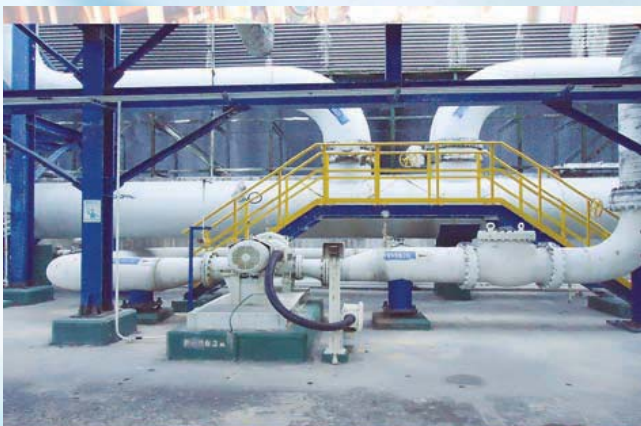
修改泵浦葉片符合現狀實際操作運轉流量，以節省馬達電力耗用。
