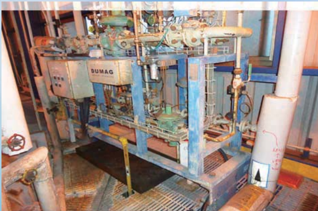
廢氣丙烷由原排至燃燒塔(K871)處理，改送至高溫氧化器(K821)燃燒，降低燃燒塔所需14K霧化蒸氣用量。
