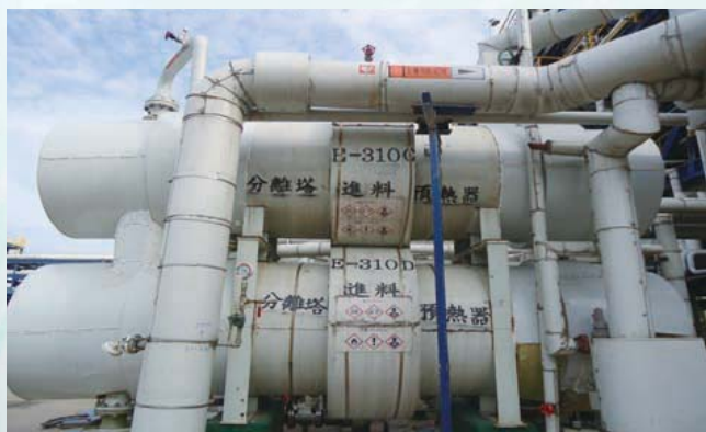
增設分離塔進料預熱器(E310A/B/C/D)，回收蒸氣冷凝水熱能，做為預熱分離塔(C311)入料液，減少進料加熱器(E313/A)蒸氣用量。
