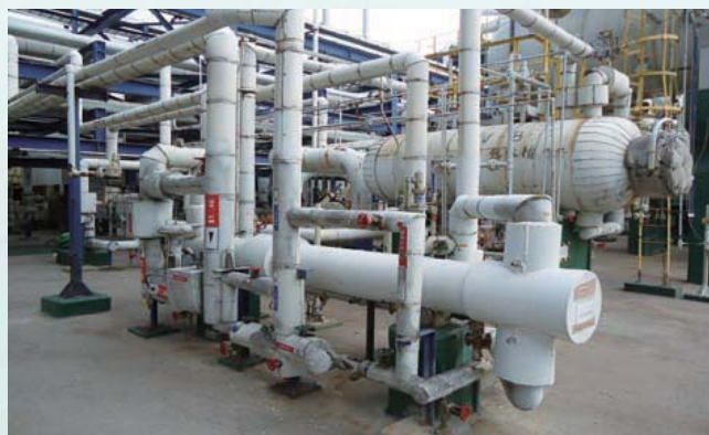
熱水系統改用蒸氣冷凝水加熱，回收冷凝水熱能，停止原熱水加熱器(E852)蒸氣耗用，以減少低壓蒸氣用量。
