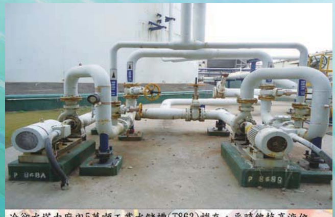
冷卻水塔由廠內5萬噸工業水儲槽(T863)補充，平時維持高液位(80%, 16M高)，足以重力流方式補充至冷卻水塔(2M高)，因此可停掉泵浦P868運轉，以節省電力耗用。
