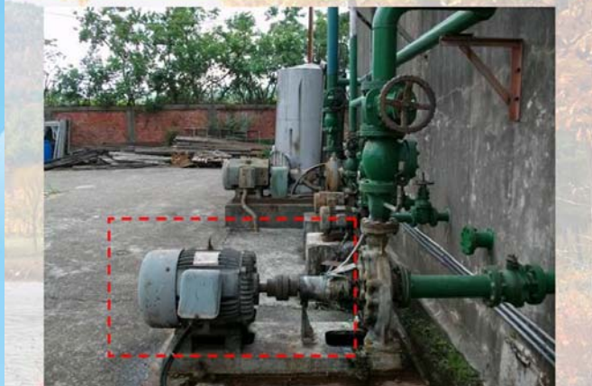
原水泵75HP改用25HP
