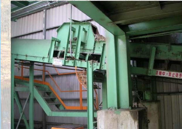
流體化床鍋爐資源再利用進料設備
