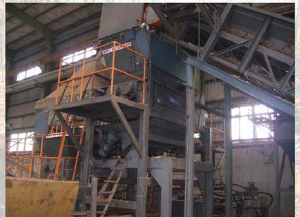
R.D.F 製程破碎設備
