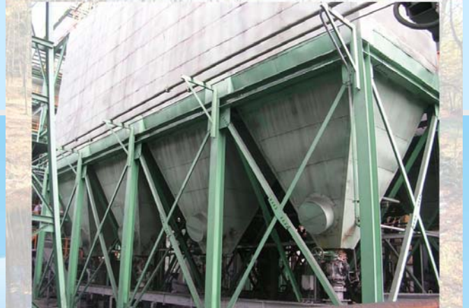
氣泡式流體化床汽電鍋爐環保集塵設備
