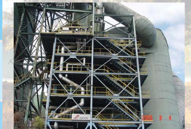
廢熱發電系統—利用旋窯廢熱進行發電
