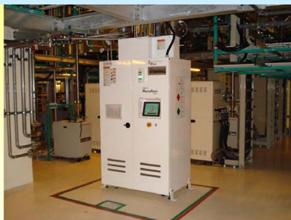
燃燒式局部尾氣破壞去除設備(Local Scrubber)，可將經過製程使用後之含氟化學物質去除，去除效率(>95%)
