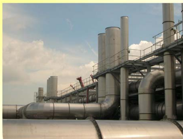
固定污染源排放管道，最終廢氣排放
