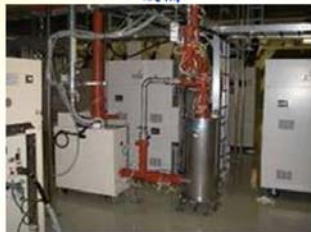
CVD製程中的燃燒式廢氣處理設備
