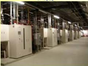
乾蝕製程中的燃燒式廢氣處理設備
