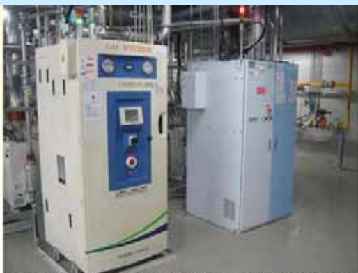
『燃燒式局部尾氣處理設備』
