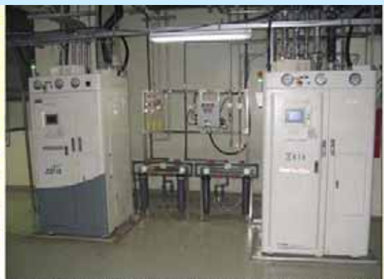
『電熱式局部尾氣處理設備』
