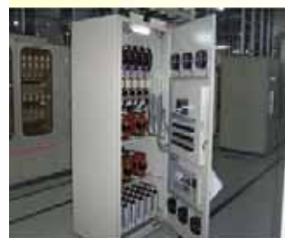
功因改善盤內部
