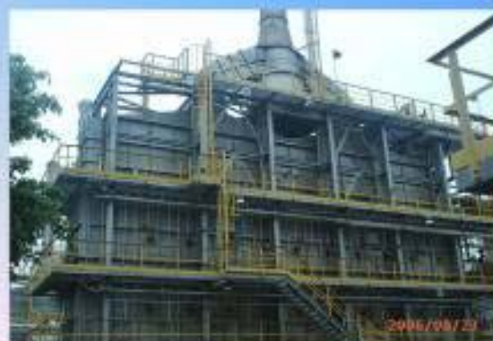
裂解爐提高裂解率降低能源使用
