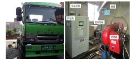
車輛、船舶清碳環保及工業鍋爐
