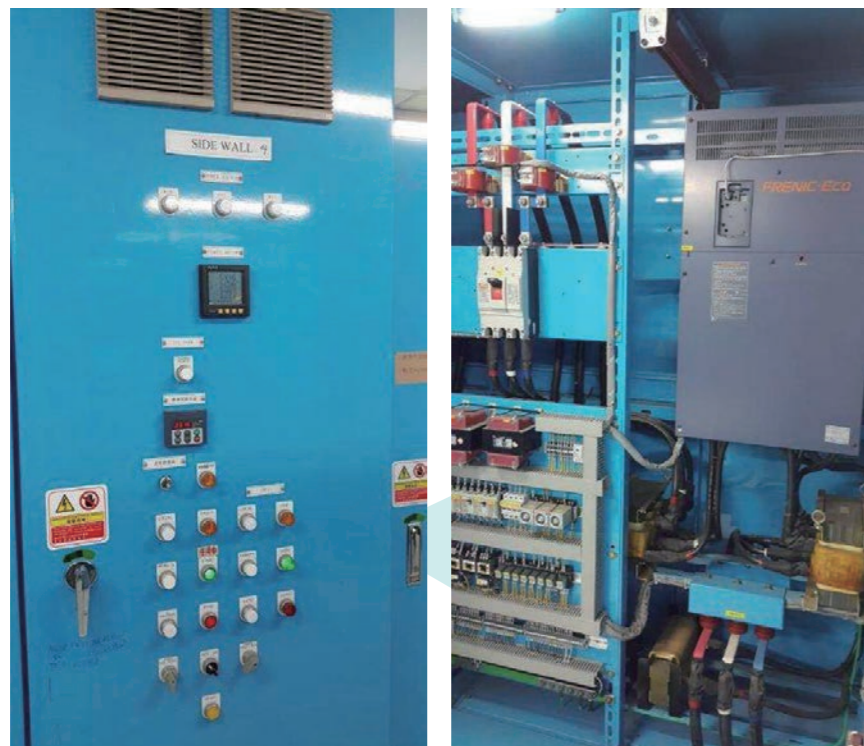
圖 4.3.3-1 改造後系統盤櫃照片
