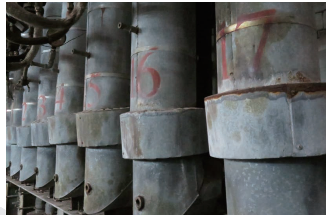
圖 4.1.1-2 改善前燃燒機分布情形
