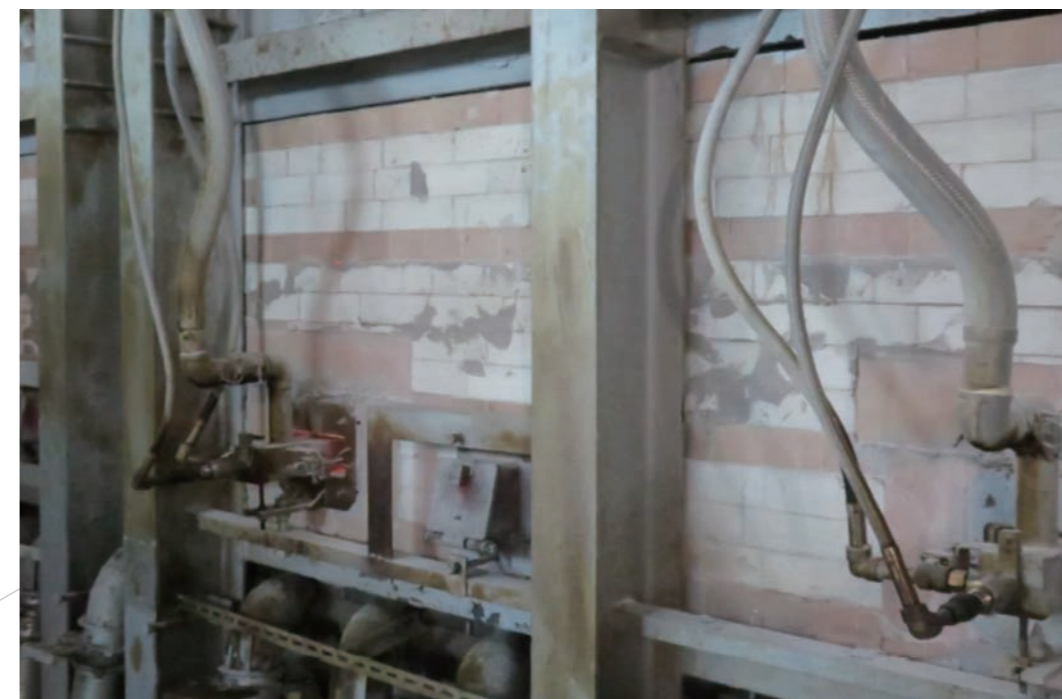
圖 4.1.1-3 改善後燃燒機分布情形
