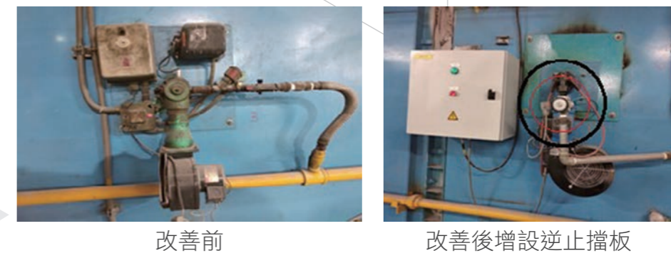
圖 4.2.4-1 徐冷爐天然氣逆止擋板
