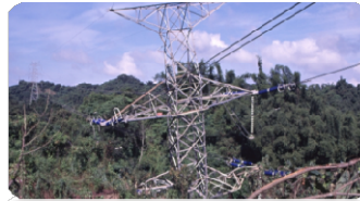
水電基礎設施失效
