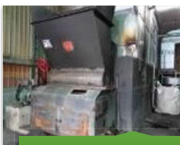
燃煤熱媒鍋爐
