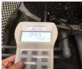
冷卻水塔未進行水質管理
