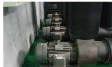
水泵未導入變頻控制
