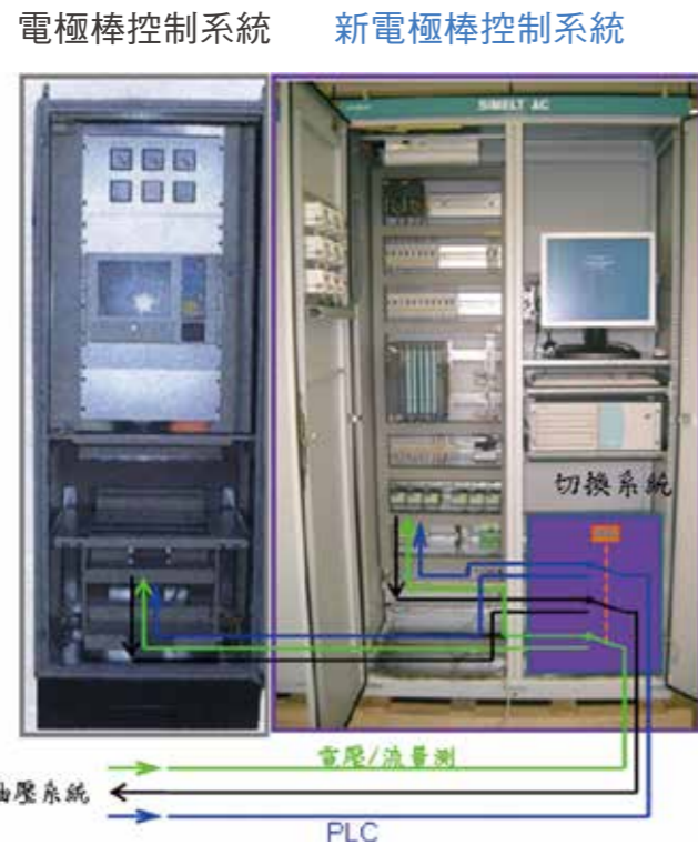
圖 4.4-3 改善後電極棒控制設備
