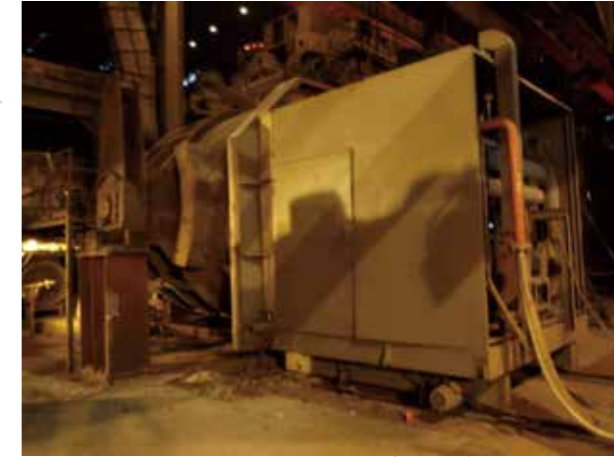
圖 4.4-11 改造後盛鋼桶預熱器照片
