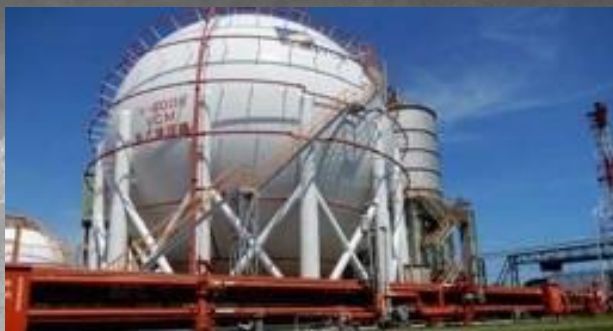
➢ 台氯公司林園廠VCM球槽
