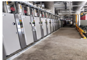
天然氣貫流式鍋爐(18台2.5噸)
