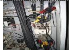
主機耗電量量測
