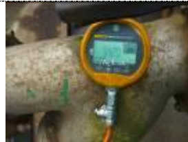
泵浦進出口壓力量測
