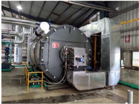
改善後熱煤鍋爐
