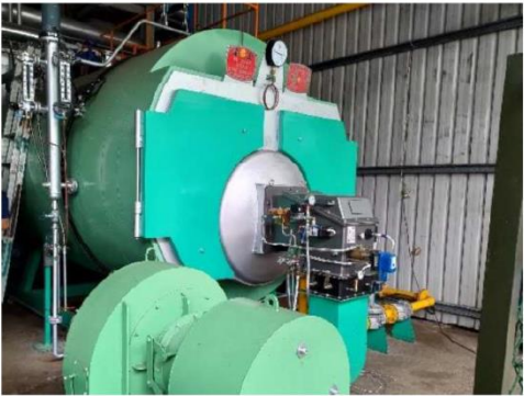
改善後蒸氣鍋爐
