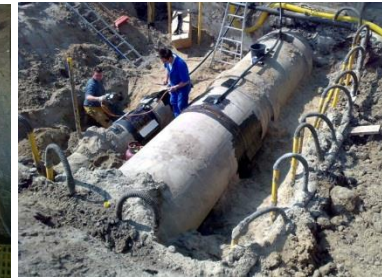
地下水泥管道
