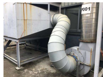
風管急彎壓損大
